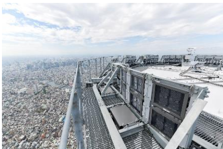
△東京スカイツリーに実際に設置されたライティング用の照明機器
